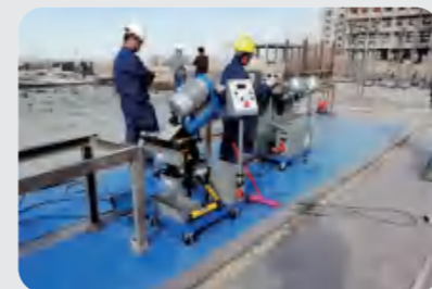
客户现场 Customer site
